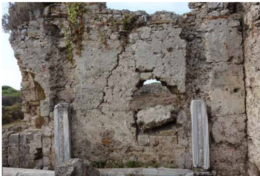
fig. 12 Church in the residence, southern wall © ÖAW/IKAnt (A. Pülz) Сл. 12 Црква у резиденцији, јужни зид © ÖAW/IKAnt (А. Пилц)
